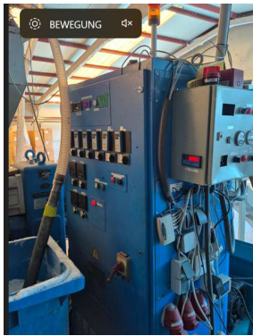
1.4 Extruder mit Schaltschrank und Trichter
